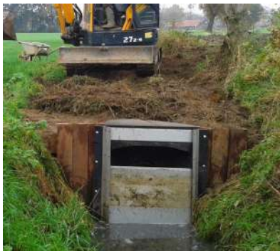
Voorbeeld van een stuwte om afvoer van hemelwater te sturen via boerennatuur.be
